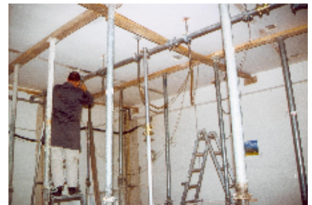
Messsystem (induktive Wegaufnehmer) an der Unterseite der Decken
