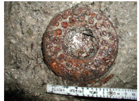
Spannanker mit chloridindizierter Korrosion
