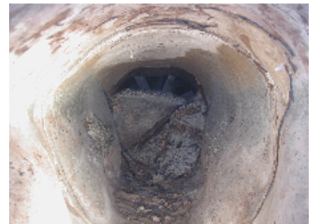
Eingedrückte Hohlkörper durch Verschiebung der Holzschalung
